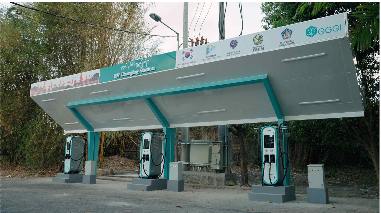
* 인도네시아 발리에 설치된 전기버스 충전소(Electric Bus Charging Stations Installed in Bali, Indonesia)
