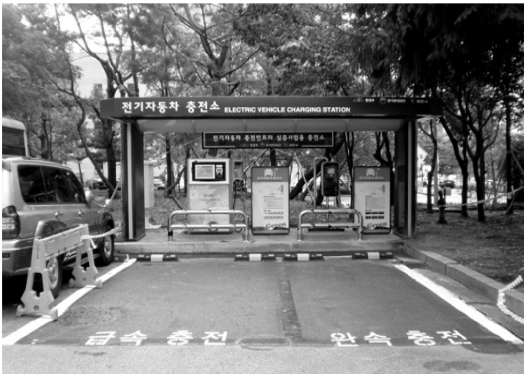
<충전기 설치후 전경(실외)>
