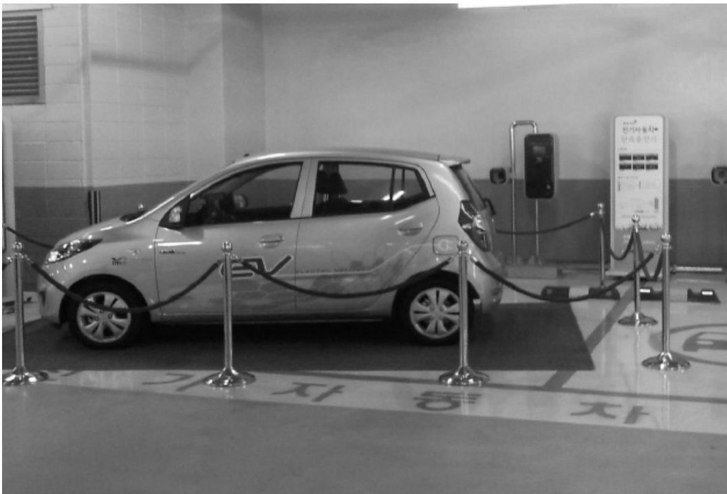
<충전기 설치후 전경(실내)>
